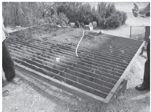
写-32 詰りが激しいため撤去されたスクリーン(写-28地点)
