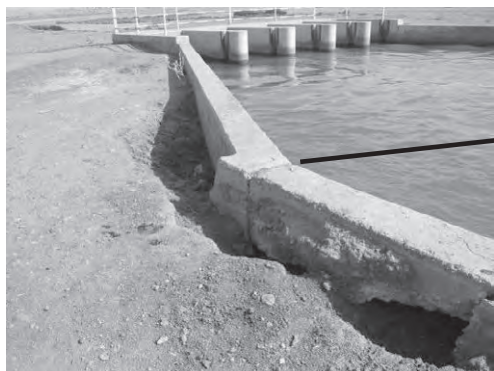
写-29 サイホン部吐口拡幅部右岸側側壁 の欠損
