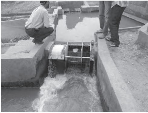
写-5 分水機器 (右側 2 カ所のカバーは盗難により欠損)
