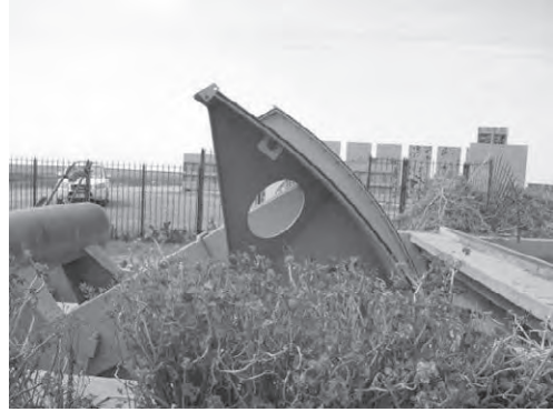
写-34 高位部幹線水路 (II 期地区)末端部ゲート及び角落し(ゲート背後)
