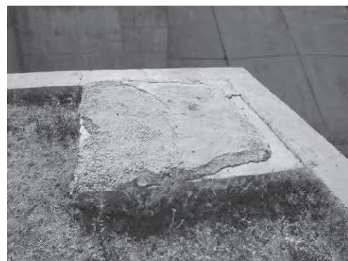
写-40 幹線水路底部ドレーンの排出用マンホール (いたずら防止のためコンクリートを上塗り)
