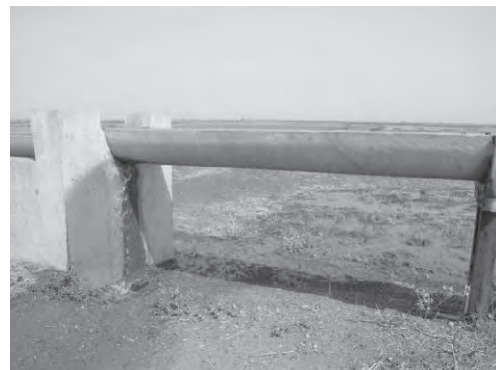
写-15 2次水路漏水箇所
