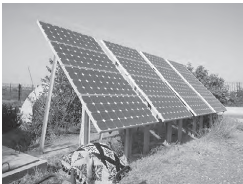
写-37 太陽光パネル (通信施設動力源)
