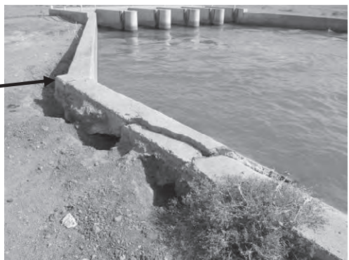
写-30 左に同じ(側壁頂部のクラック)
