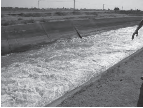
写-13 低位部幹線水路側壁 (施工目地のズレ)
