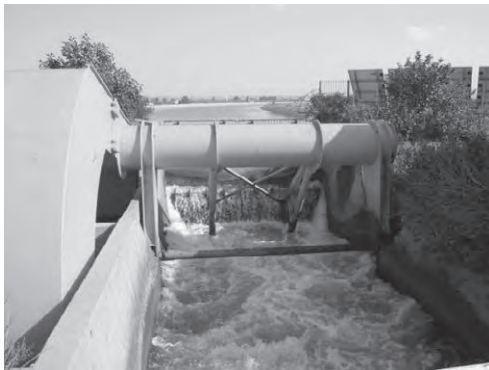
写-35 幹線水路水位調整ゲート
