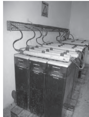
写-36 ソーラーパネル・バッテリー(老朽化が進行)
