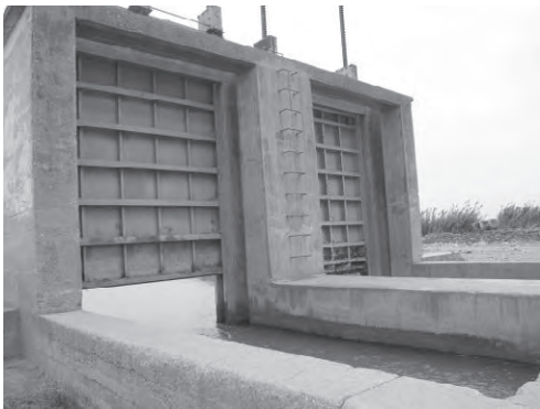
写-11 幹線水路開閉ゲート (巻上機器は盗難防止策として撤去)
