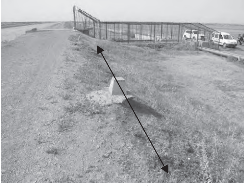
写-1 高位部幹線水路取水箇所（上流より14番目）。管理用道路の路肩侵食
