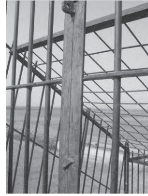
写-2 鍵が盗まれた盗難防止防護柵
