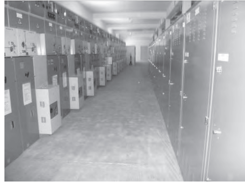
写-10 ポンプ操作盤
