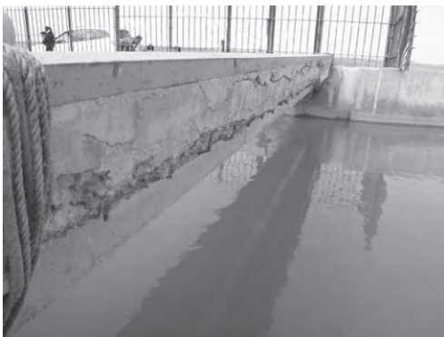
写-28 水位調整堰部のコンクリート梁(施工が荒い)
