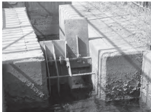
写-24 分水機器 (鋼製のため一部盗難により欠落)
