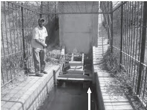
写-21 幹線水路からの流量調整機器
