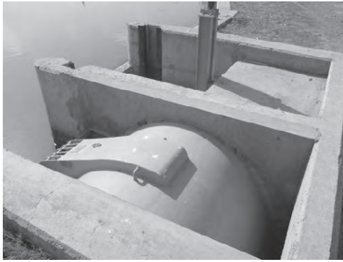
写-33 幹線水路余水吐 (鋼製：自動、ゲート：手動)
