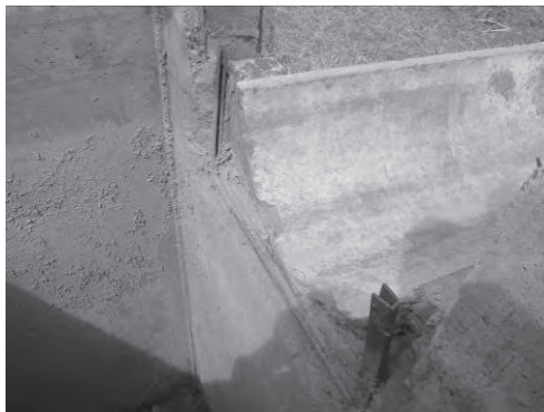
写-31 4次水路分岐箇所の鋼板 (止水板)戸当り(鋼板・盗難)
