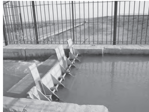
写-4 一部が盗まれた分水機器
