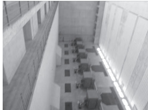
写-12 ポンプ室上部 (ポンプ 12 基)
