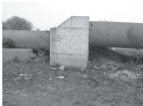
写-20 1次水路落差工 (漏水あり)
