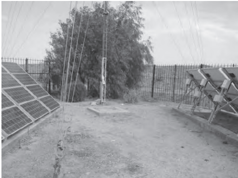
写-35 高位部幹線水路 (II 期地区)末端部ソーラーパネル及び通信塔
