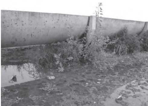
写-19 1次水路 (半割フリューム管) 漏水箇所
