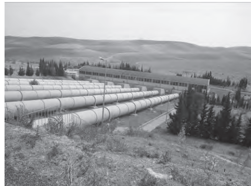
写-14 ポンプ室から吐水槽への送水管 (6 本)
