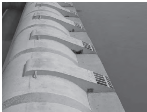
写-18 左に同じ (余水吐ゲートの錆)
