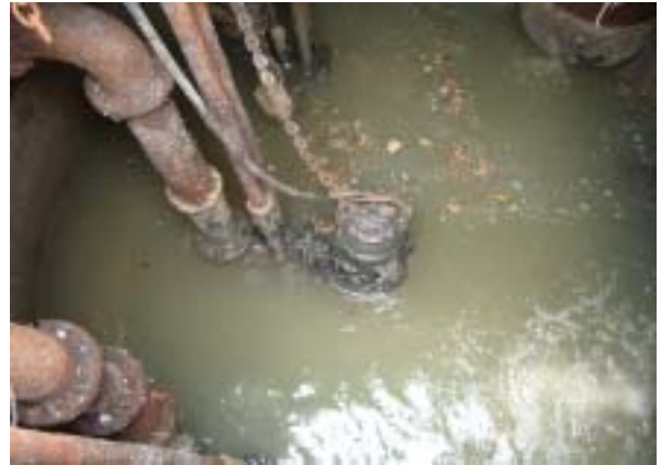
Lawes RdElaのポンプステーション内部状況
