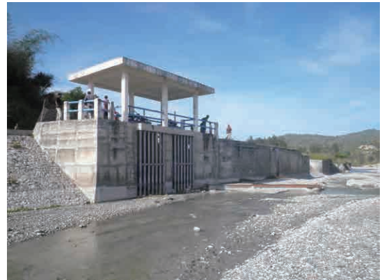
カラウルン左岸取水部 (2006年にARP事業により改修、固定堰は撤去された)
