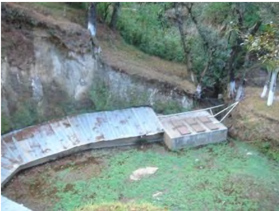
湧水集水渠 右側のタンクに小型水中ポンプ が設置されており、水槽（水場）まで送水して いる。
