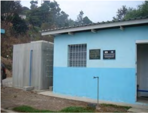
ポンプ小屋と中継タンク
