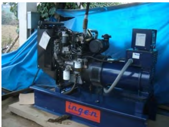
発電機 (75KVA, 60KW)
