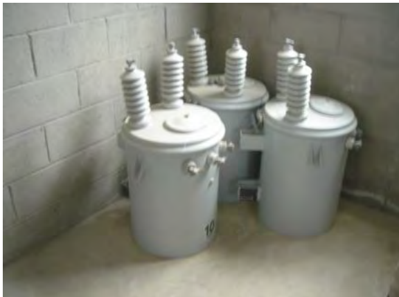
プロジェクトで調達されたトランスがポンプ小屋に保管されている。
