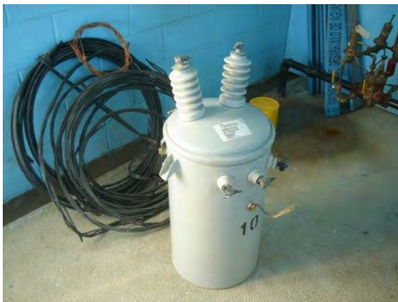
内部のコイルが焦げ付いたトランス
