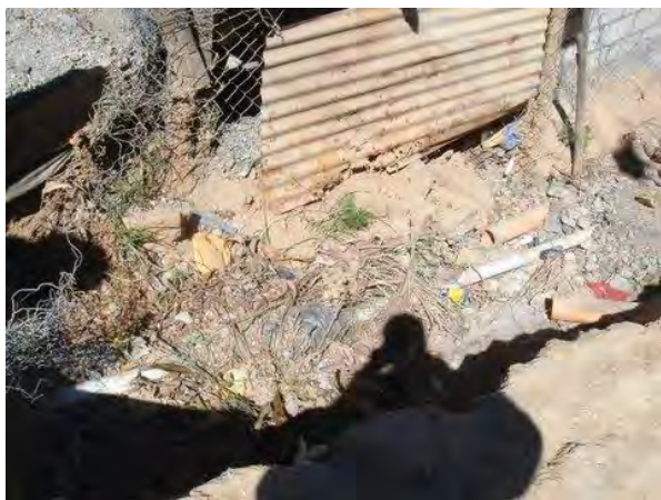
給水管路が露出している箇所
