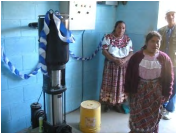
送水ポンプと制御盤
