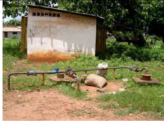
深井戸傍の揚水ポンプ場
