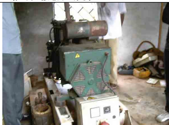
揚水ポンプ場内の発電機
