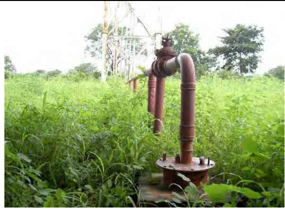
水源の深井戸 深度 170m、水位 25m、揚水量 25~50 m 3 /h、水中ポンプが 15 年前のもので調子悪いが稼動している。
