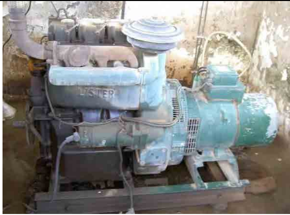
水中ポンプ用の発電機 LISTER 製発電機 (7.5kW)、故障しており使っていない。電源は、配電網を利用している。
