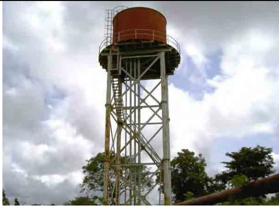
約 50 年前のポルトガル統治時代の高架水槽 スチール製高架水槽 (60 m 3 )、現在も使用している。
