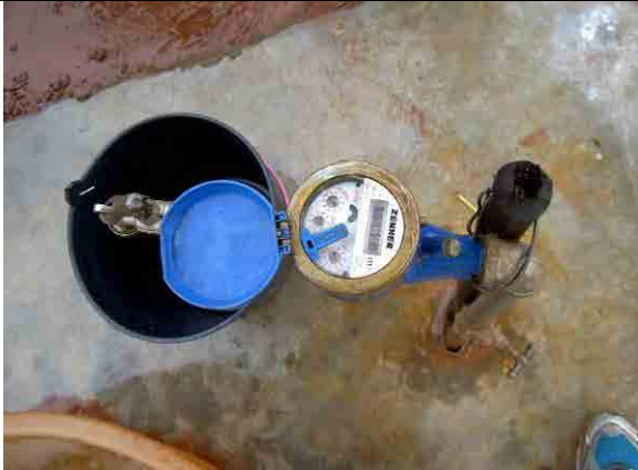
各戸接続の水道メーター 蛇口の水道管に直接付いている。144 m 3 を指していた。
