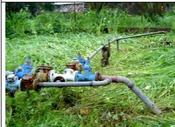
水源の深井戸 現在使われているのはこの1本のみ。深度約 200m。同じ敷地内の高架水槽に送付する管と高架水槽を bypass しない配水管がある。
