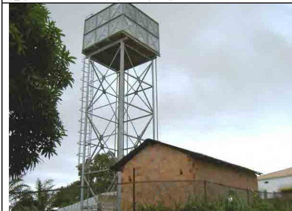
1996 年から使用している給水施設。 スチール製高架水槽 (30 m 3 ) と揚水ポンプ場。 同じ敷地内に上記深井戸がある。
