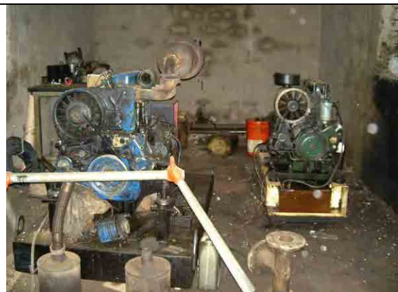
左の写真の揚水ポンプ場内の発電機 発電機が 2 台あるが、2 台とも故障修理中なので、3 か月前から給水されていない。
