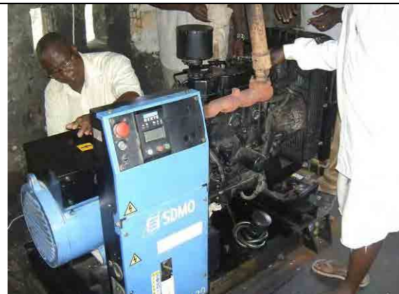
揚水ポンプ場内の発電機
