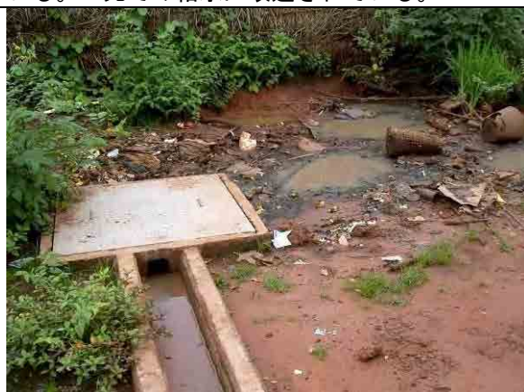
排水ピットと浸透升
