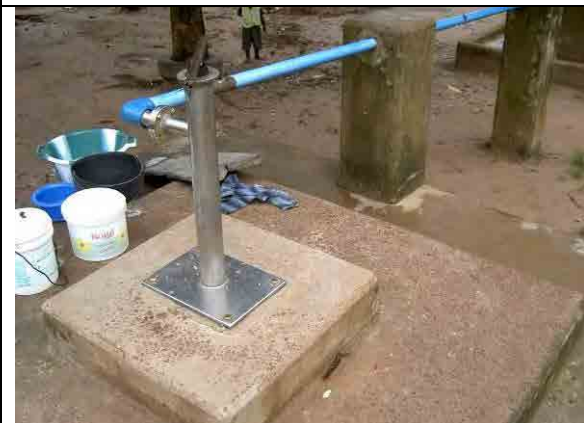
Bor 村人力ポンプ（その2） 1週間前から故障中（ピストンのパッキン交換必要と思われる）
