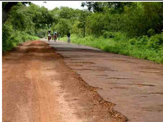
Mansaba～Far im 間の道路 舗装が剥げて孔が多く、状況悪い。路肩を通行している箇所が多い。大型車も通行は可能。
