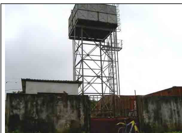
2000年にオランダの支援による給水施設 深井戸、スチール製高架水槽（58 m 3 ）、揚水ポン プ場が同じ敷地内にある。
