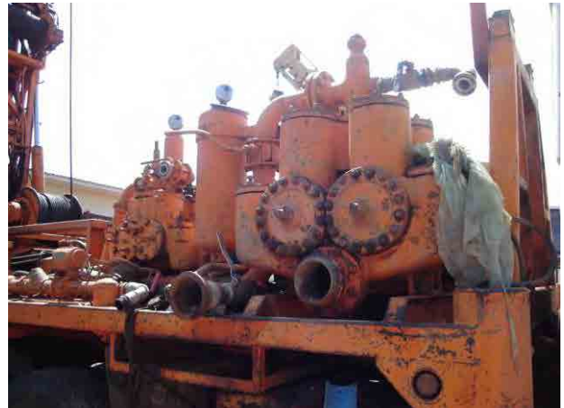
左記リグに搭載されている泥水ポンプ
