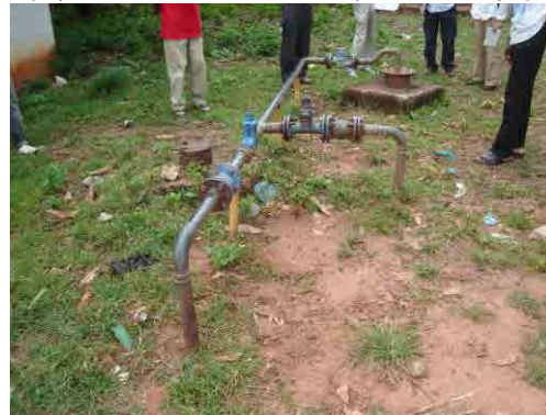
Mansaba 町の水源。井戸口径が小さく、設置できるポンプの揚水量が限られているため、新設が要請されている。
