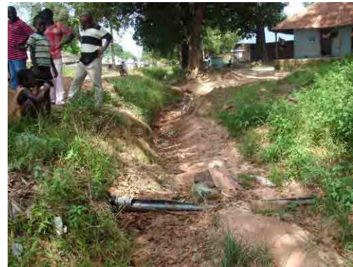
"Farim 準都市：露出している PVC 製既存管 (改修が必要)"
