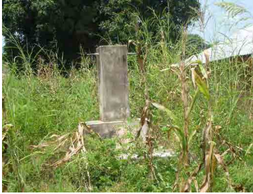
標準的な共同水栓： 改修の要請有り
