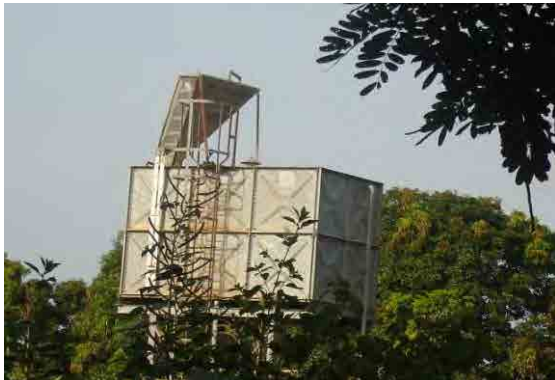
同上：鉄分が多いため、配水池の上に除鉄装置が設置されている
