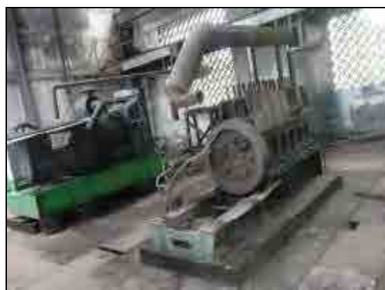
マンサバ市国営電力公社建屋跡内に放棄された発電機
