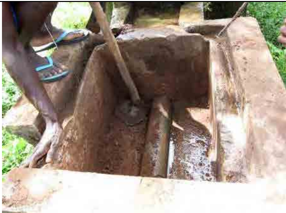
Caramoco 村の鉄除去装置の砂フィルター 掘ってみると、底部の集水管スクリーンまで土が入っていた。
