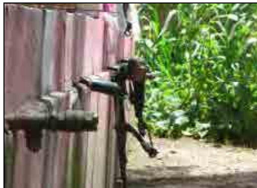
各戸給水栓（マンソア町）
