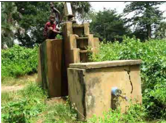
ニャクラ郡 Cola 村の鉄除去装置 砂濾過槽内は、周辺の土壌と入れ替わっていた。
