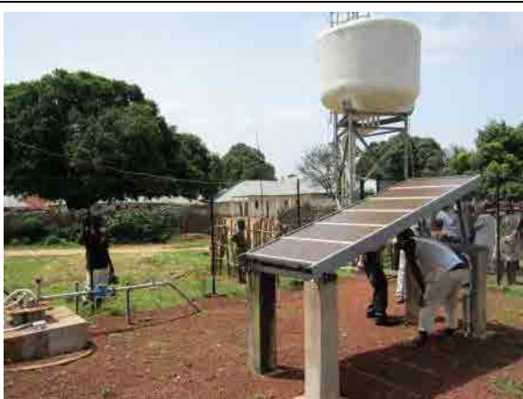
マンゾア郡 Bafata Oio 村太陽光揚水システム PRS フェーズ 2 により 2008 年に建設された。揚水量は 11 m 3 /day。高架水槽は容量 10 m 3 、高さ 4m。
