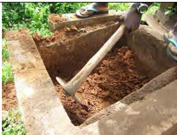
Caramoco 村の鉄除去装置の砂フィルター 砂濾過槽の蓋を開けると、砂でなく周辺の土が入っていた。
