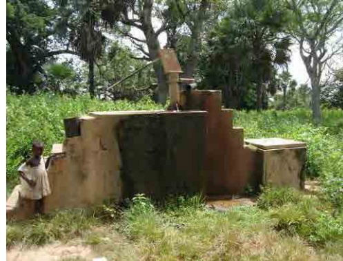
"1997 年建設の除鉄装置 (Cola 村-Nhacra) 除鉄装置は使われていないが、ポンプは稼働中"
