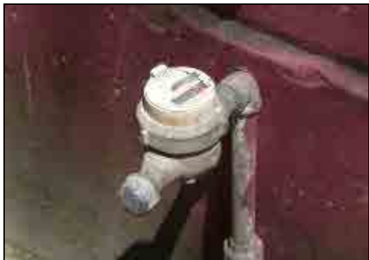
各戸給水メーター（マンソア町）
