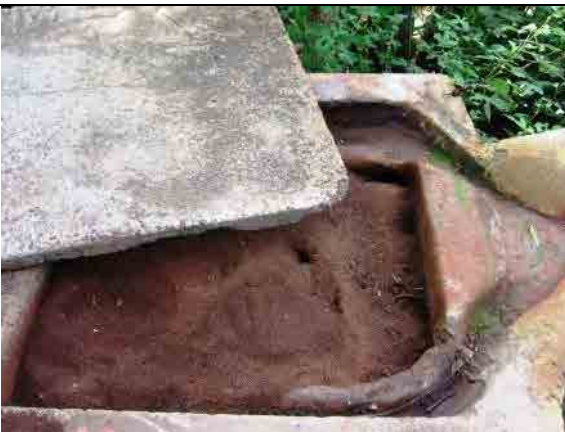
ファリム郡 Rcaurba 村の砂フィルター 1997年 UNDP 建設。濾過槽に正規の砂が入っていた。2週間に1回洗浄していたとのことで、今年6月まで稼働していた。ポンプのシリンダー部の故障で未稼働。
