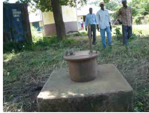
鉄分が多いため、未使用。現在、観測井となっている。(Manosa 町)
