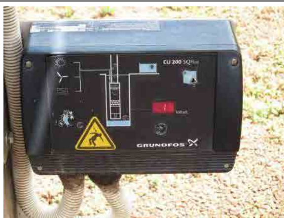
同左の太陽光のコントロール部 GRUNDFOS 社の直流水中ポンプによる太陽光揚水システムの SQFlex シリーズが使用されている。
