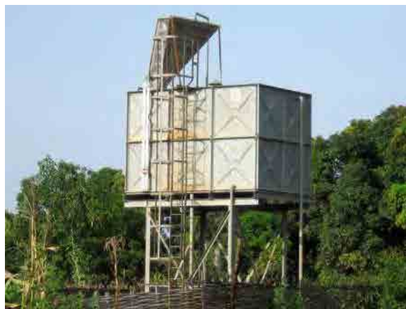
同左の高架水槽と鉄除去装置 容量 12 m 3 。上部の鉄除去装置は、シャワー式のエアレーション部と砂フィルター部からなる。
