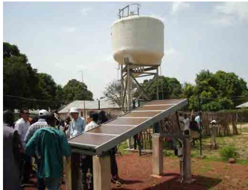
PRS-II (2008) に建設されたソーラー給水システム (Bafata-Oio 村) 水量：11m 3 /日
