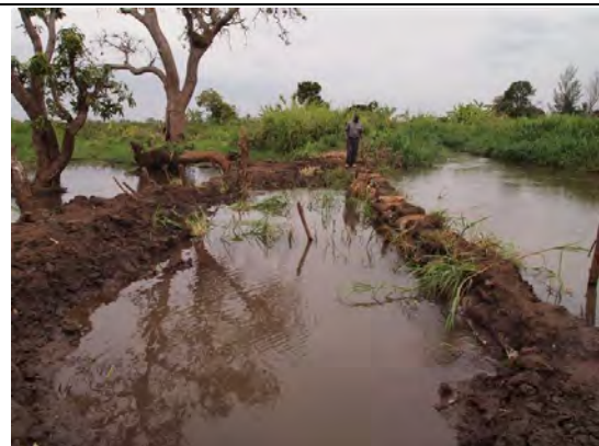
Lumi川左岸下流部における破堤部復旧状況。撮影時点で700袋の土のう、延べ動員約2,000人。
