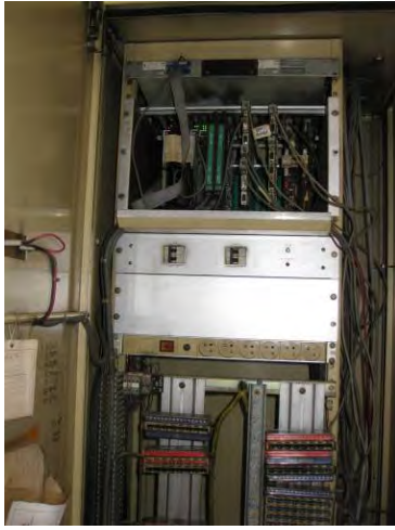
図 2 - 16 RMU 用遠方制御装置 (RTU) PLC が適用されていた。
