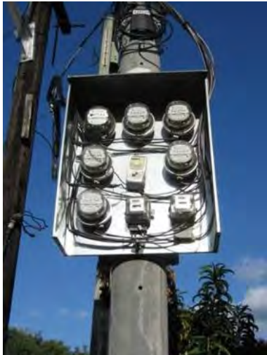
図 6-8 盗電の懸念が多い EC における 一般需要家の電柱一括管理状況の一例
