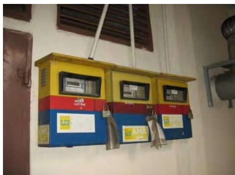
図 2-23 電力量計の取付状況の一例
