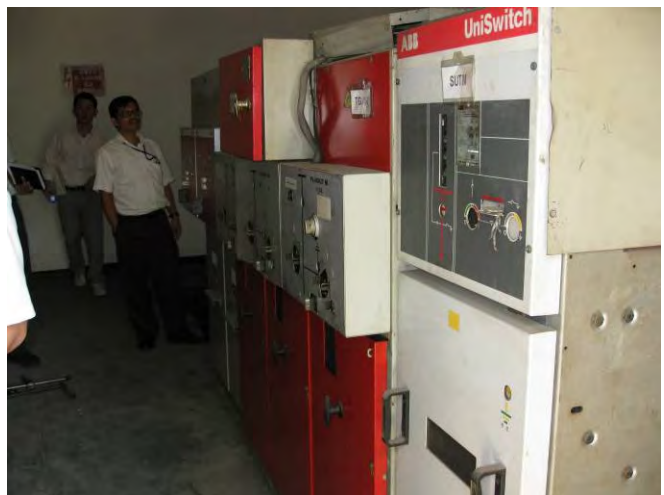
図 2-15 中間ポイントの負荷開閉器 (LBS) 架空系統用にもかかわらず RMU が使用されている (地中系統用と同じ)。
