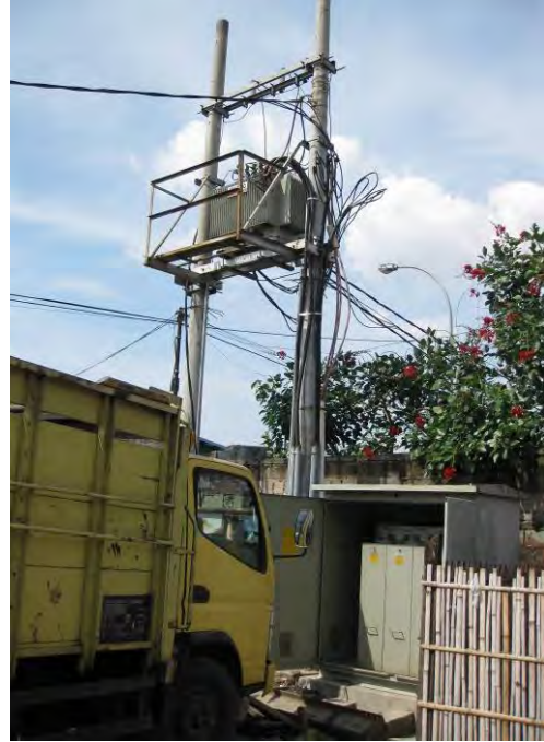
図 2 - 17 変圧器は電柱に設置 (架空系統では、変圧器は架空に設置されていたが、RMU と接続するため地中に変更し接続している。)
