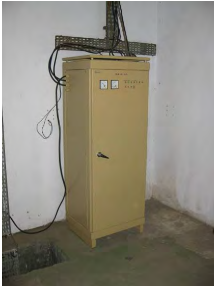
図 2-20 Switch Station 用 RTU (がれきのなかに設置)
