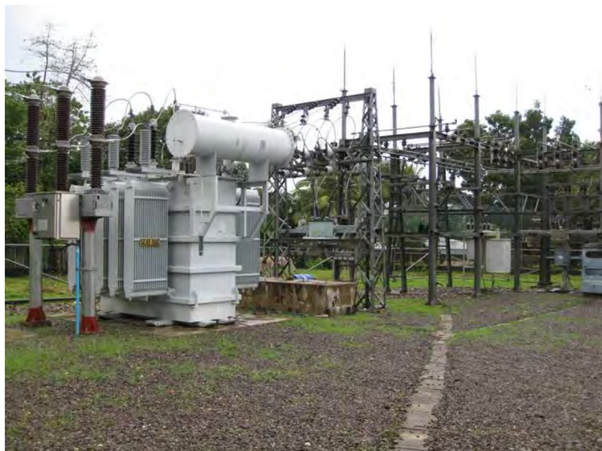
図 6-4 古い変電所の例
