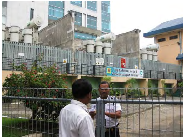
図 2-8 配電用変電所
