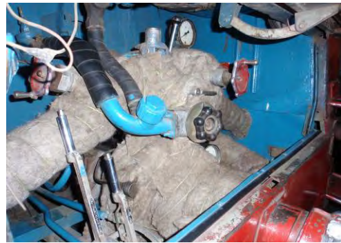
消火ポンプ装置周囲は、凍結防止のため布類を巻きつけている。
