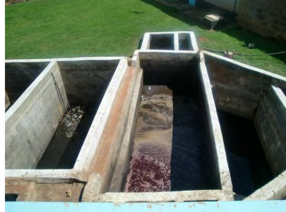
好気性処理タンク
