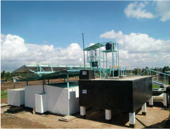
バイオガス・プラント全景
