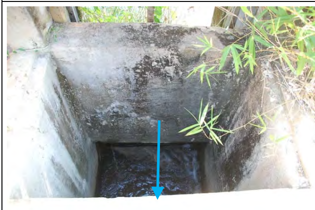
写真-16 アンズ・グローブ取水口本体の現況 コンクリート構造物の表面に小ひびわれは見ら れるが、取水機能は満足しているため改修対象外 とする。
