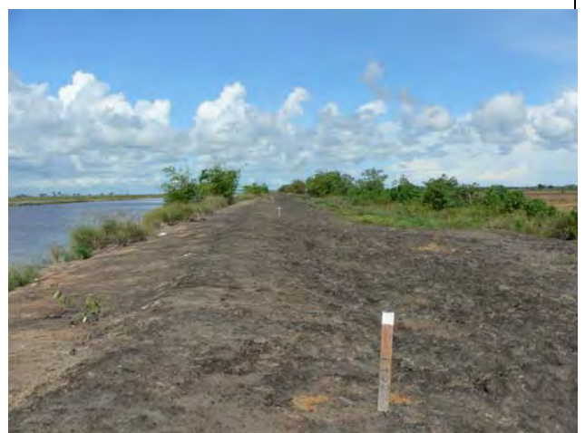
写真-11 雨期を経験した堤体の盛土の状況 降雨による堤体土の侵食により、クラックが充填され、硬化している。
