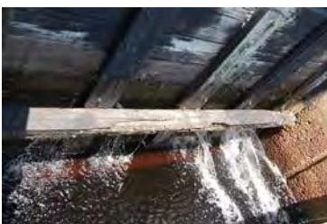
現況-3 ドア漏水状況(2)
