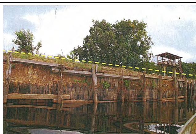
写真-13 マドゥニ排水門附帯施設（貯水池側老朽 木製擁壁工） 老朽化に伴い木製翼壁（排水門流入側・流出側） が破損しているため改修する。
