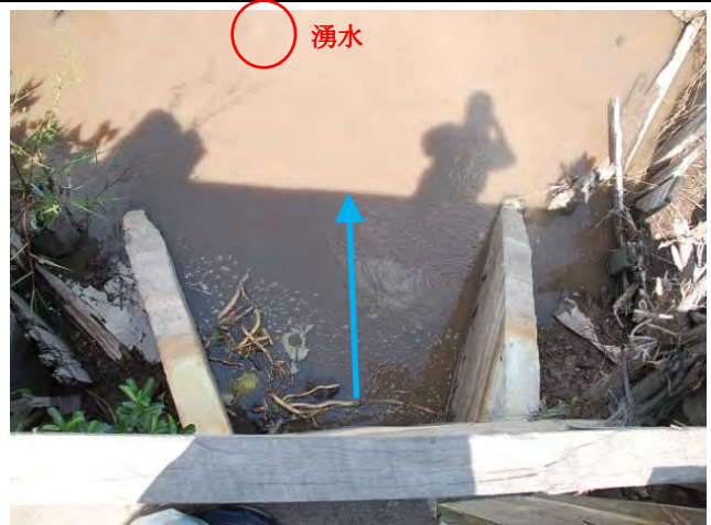
写真-19 ホープ取水口・吐口部の漏水・湧水状況 本体底版下の基盤土の沈下により隙間ができ、貯水が漏水しているため呑口側に止水壁を設けることとする。湧水確認位置を示す。
