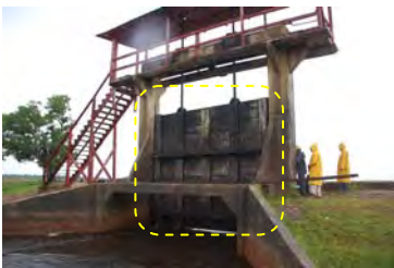
現況-1 木製ゲート老朽状況
