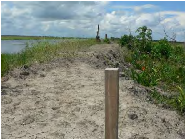
写真-8 段階盛土工法に伴う盛土の状況 法面の侵食・崩壊により堤体軸線が大きく湾曲している。
