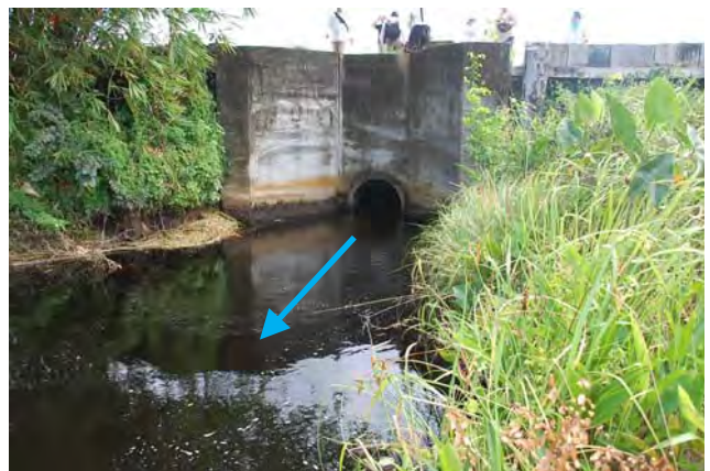
写真-21 アナンデール取水口・吐口部の現況 コンクリート構造はほぼ健全であるが、吐口側水路兩岸の木製擁壁工が破損しているため改修を行う。
