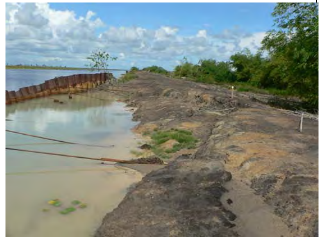
写真-9 鋼矢板による堤体の補強状況 貯水池側の法面でスベリが生じ、鋼矢板が倒壊している。
