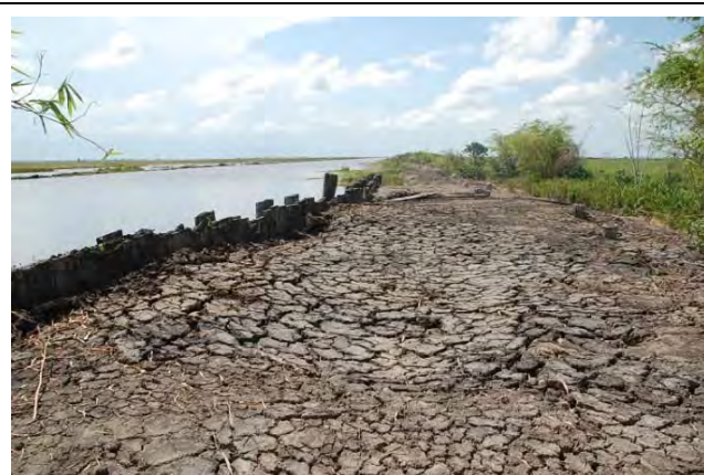
写真-17 アンズ・グローブ取水口直近部の堤体状況 堤体中に旧排水管が残置しており、その箇所から の漏水が発生し、堤体盛土が軟弱化し強度が低下 しているため改修する。また、木製擁壁工が老朽 化しているため改修する。
