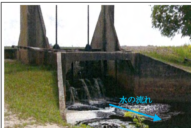
写真-12 マドゥニ排水門の漏水状況 木製扉が経年劣化により漏水しているため、扉の 全面改修を行う。
