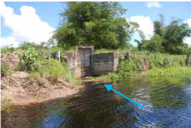
写真-20 アナンデール取水口・呑口部の現況 木製翼壁工の老朽化により堤体土が貯水池に崩落しており改修を行う。扉（水中部）の部分破損がみられるため部分改修する。
