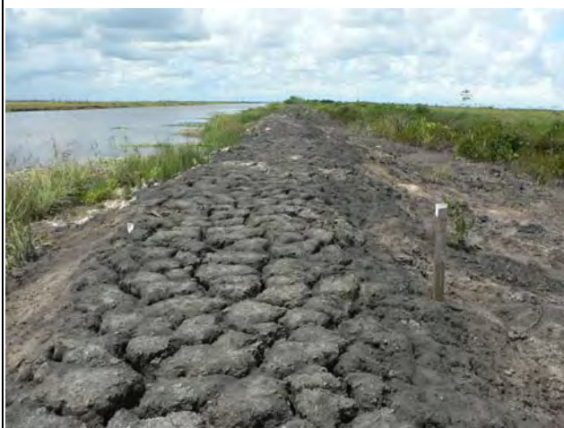
写真-10 修復後間もない堤体の盛土の状況 乾燥収縮による土塊間空隙の発生により、有機質土塊のブロック状盛土堤体となっている。
