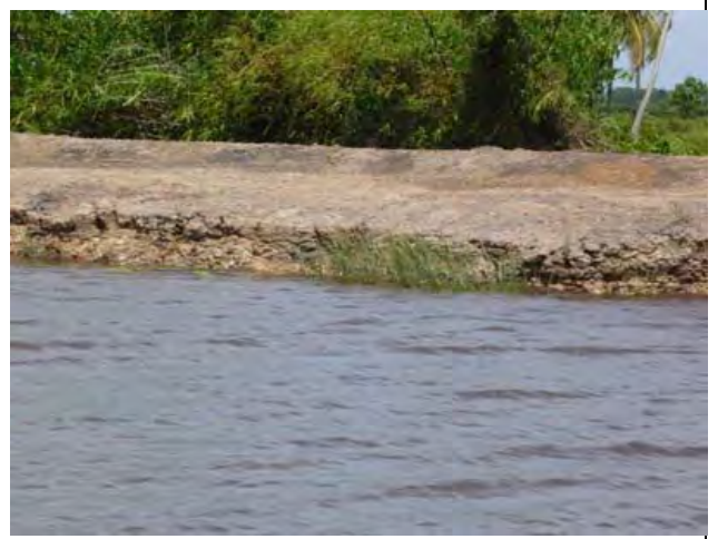
写真-7 堤体法面の崩壊 貯水池側の盛土が浸透水、乾燥収縮と波により崩壊が進み強度低下が生じている。
