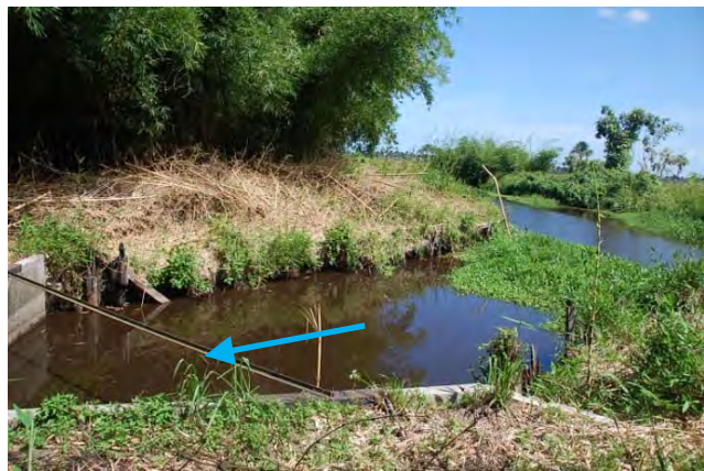
写真-22 ナンシー取水口・呑口部附帯施設の現況 コンクリート構造物本体はほぼ健全であるが、木製擁壁工が老朽化し土留め機能を失っているため改修を行う。
