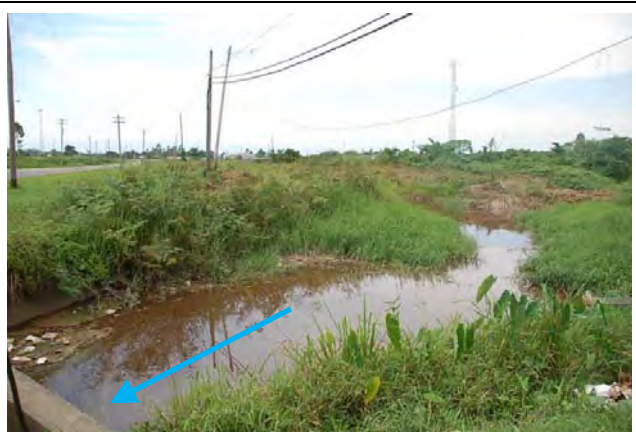
写真-15 サラ・ジョアンナ排水門への流入部水路 木製擁壁工（左右岸）が老朽化しているため改修 を行う。
