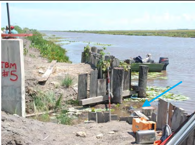
写真-18 ホープ取水口・呑口部の現況 木製擁壁工の老朽化により、土留め機能を満足していないため改修を行う。
