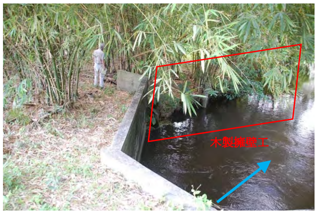
写真-23 ナンシー取水口・吐口部の附帯施設の現況 木製擁壁工が老朽化しているため改修を行う。（右岸側擁壁工も同様な老朽状態にある。）
