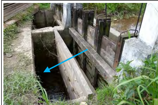
写真-14 サラ・ジョアンナ排水門ドアの現況 扉部の破損が進んでいたが、「ガ」国で改修が行われ完了しているため改修対象としない。
