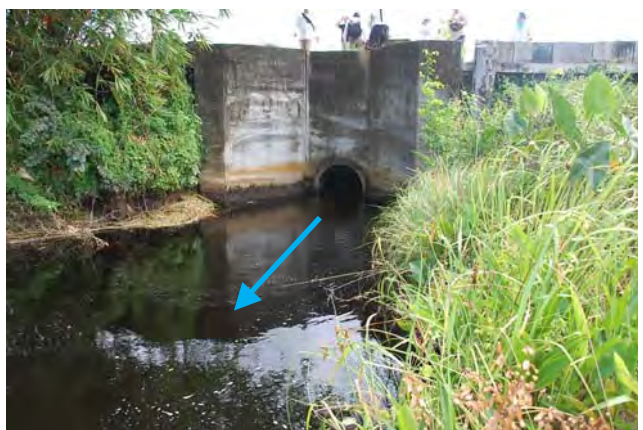
写真-21 アナンデール取水口・吐口部の現況 コンクリート構造はほぼ健全であるが、吐口側水路兩岸の木製擁壁工が破損しているため改修を行う。
