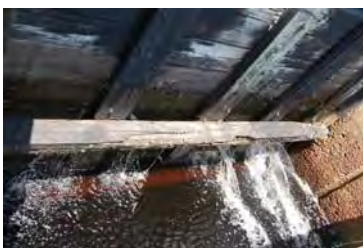
現況-3 ドア漏水状況(2)
