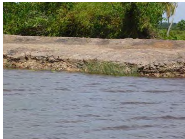
写真-7 堤体法面の崩壊 貯水池側の盛土が浸透水、乾燥収縮と波により崩壊が進み強度低下が生じている。
