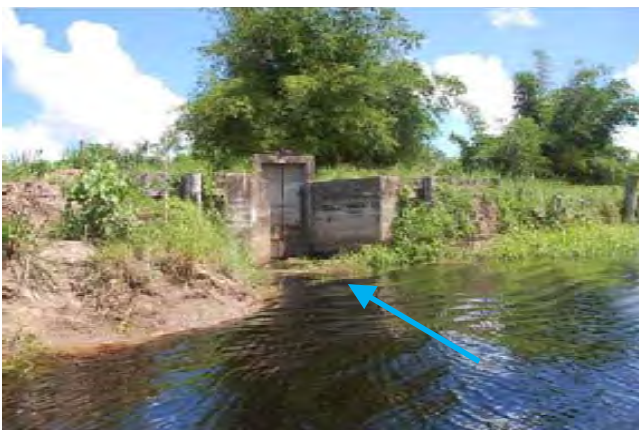
写真-20 アナンデール取水口・呑口部の現況 木製翼壁工の老朽化により堤体土が貯水池に崩落しており改修を行う。扉（水中部）の部分破損がみられるため部分改修する。
