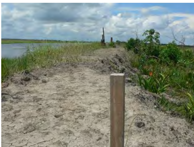
写真-8 段階盛土工法に伴う盛土の状況 法面の侵食・崩壊により堤体軸線が大きく湾曲している。
