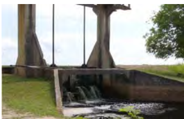
現況-2 ドア漏水状況(1)
