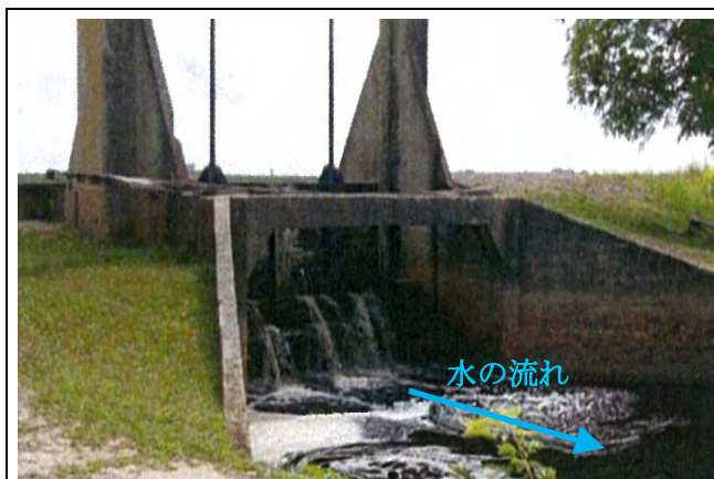
写真-12 マドゥニ排水門の漏水状況 木製扉が経年劣化により漏水しているため、扉の全面改修を行う。
