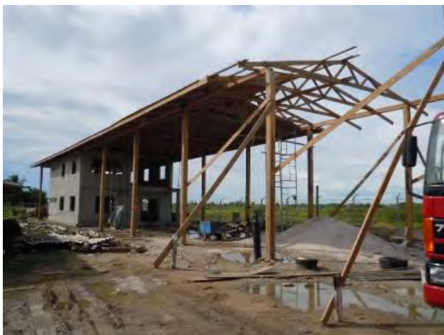
写真-6 建設中のワークショップ 調達機材の修理や維持管理に対応する。
