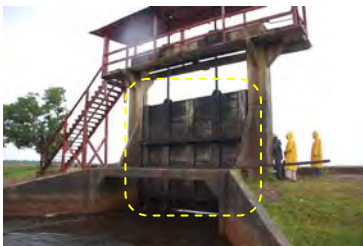
現況-1 木製ゲート老朽状況
