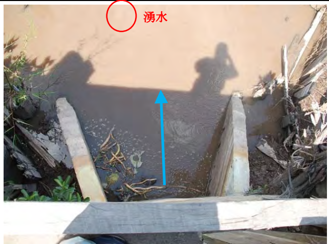
写真-19 ホープ取水口・吐口部の漏水・湧水状況 本体底版下の基盤土の沈下により隙間ができ、貯水が漏水しているため呑口側に止水壁を設けることとする。湧水確認位置を示す。
