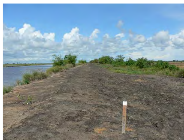
写真-11 雨期を経験した堤体の盛土の状況 降雨による堤体土の侵食により、クラックが充填され、硬化している。
