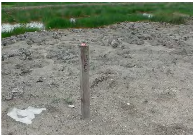
写真 3-2-1 盛土天端：未転圧状態
