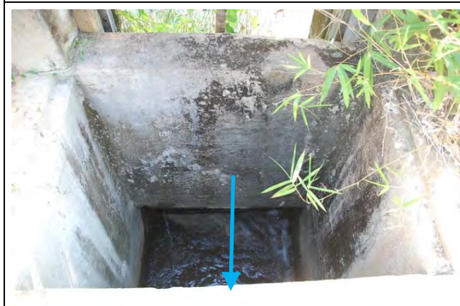
写真-16 アンズ・グローブ取水口本体の現況 コンクリート構造物の表面に小ひびわれは見られるが、取水機能は満足しているため改修対象外とする。
