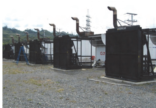
ディーゼル発電機 (HYUNDAI) (1.4MVA×8台)
