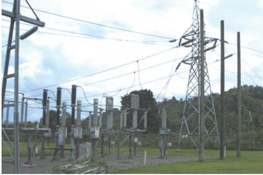
132kV 送電線引込口
