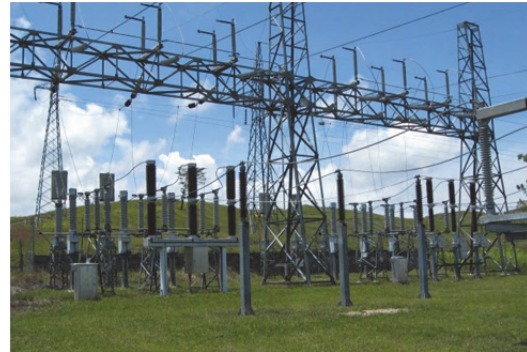
132kV 送電線 (Erap,Gusap) 引出口
