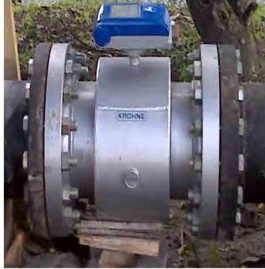
Medidor de Caudal
