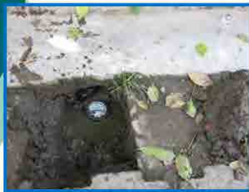
MEDIDOR EN CANALETA DE CALLE
