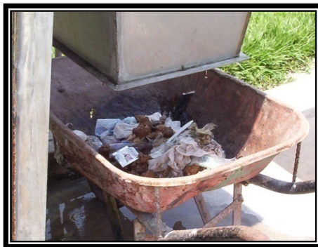
Fig. 3-3-2 rejas metálicas con limpieza automática y material retenido
