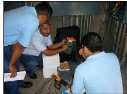
ANDA 本部の受配電施設における JICA 調達機材「力率計」の取扱方法のトレーニングの様子
