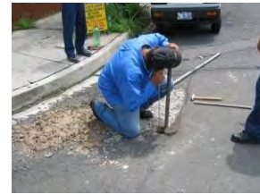
バルブの閉止を確認
