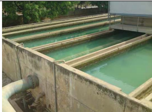
Zamfara 水公社の浄水場の水処理工程。原水の濁度が次第に低下していく。
