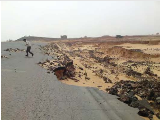
2010 年 9 月洪水による Goronyo 洪水吐きの破損状況。
