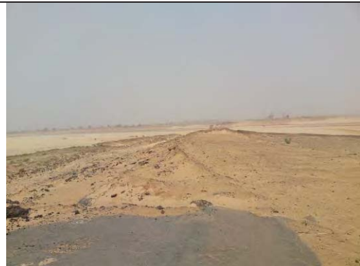
2010 年 9 月洪水による Goronyo 洪水吐きの流出・破損状況。
