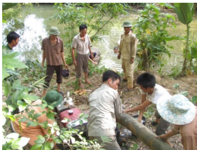
ポンプの活用
