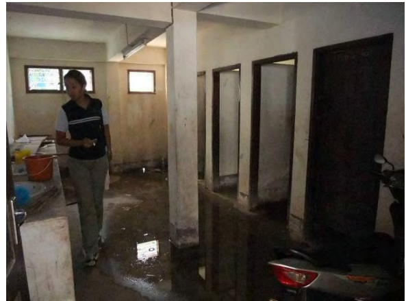
ຫ້ອງນ້ຳ 14 ຫ້ອງບໍ່ມີສຸກຂະອານາໄມ - ໂຖສັວມເບື້ອນຫລາຍ ແລະ ພື້ນຫ້ອງນ້ຳບໍ່ສາມາດລະບາຍນ້ຳໄດ້,
