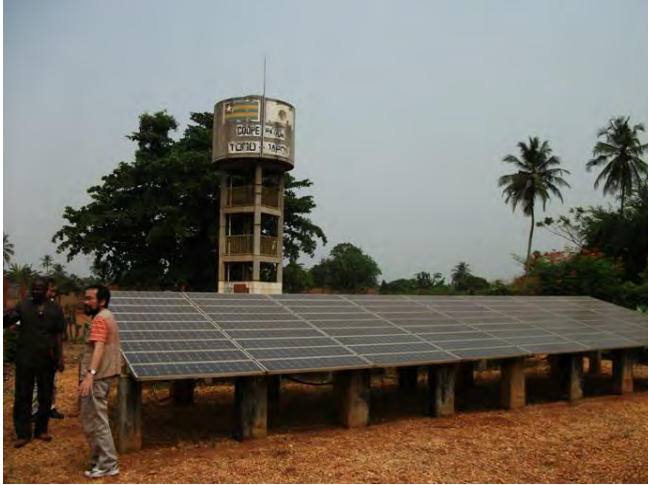
写真-1 日本の「村落給水計画(1997～2000年、第4次無償)」で建設されたソーラーシステム式小規模給水網施設(マリタイム州アゴメ村)
