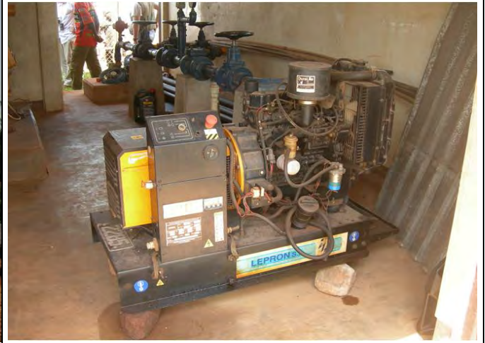
写真-2 日本の「村落給水計画(1997～2000年、第4次無償)」で建設された発電機式小規模給水網施設のポンプ室(マリタイム州ゾロ村)
