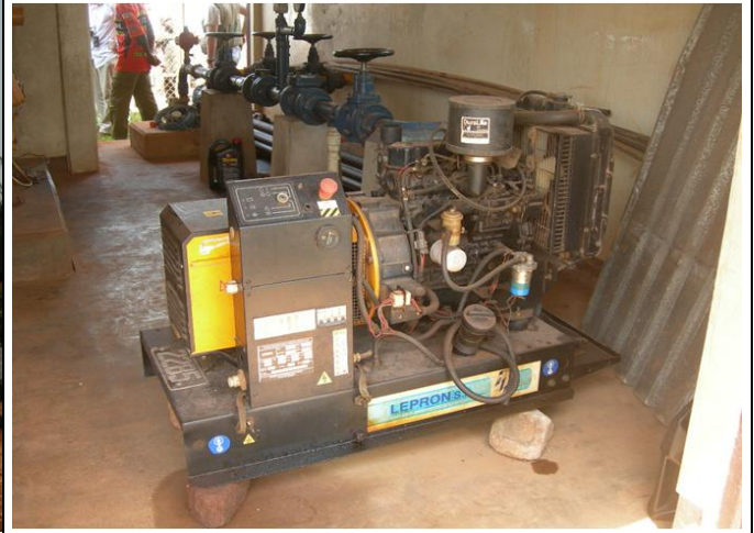
写真-2 日本の「村落給水計画(1997～2000年、第4次無償)」で建設された発電機式小規模給水網施設のポンプ室(マリタイム州ゾロ村)
