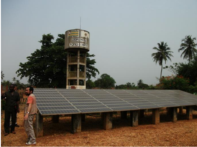
写真-1 日本の「村落給水計画(1997～2000年、第4次無償)」で建設されたソーラーシステム式小規模給水網施設(マリタイム州アゴメ村)
