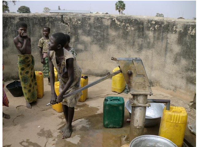
写真-8 計画対象地区：サバナス州タンジュワレ県ナノ村の人力ポンプ付給水施設
