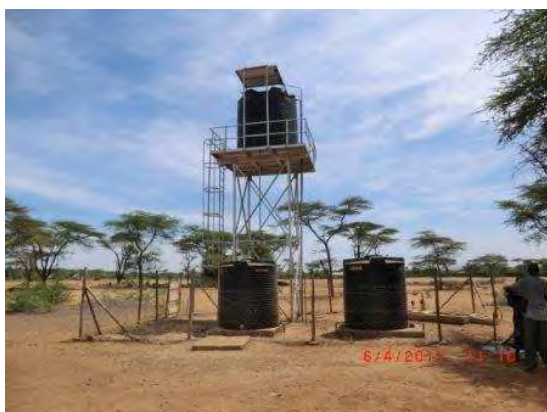
(写真-9) マリガット県、ソーラーシステムが利用されているとともに、NGO による骨炭のフッ素除去が行われている。
