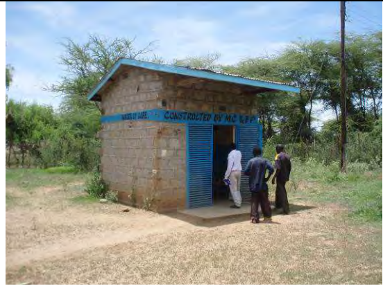
(写真-14) マリガット県にある深井戸。商用電力で近くの丘陵地に設置した配水池へ送水、自然流下で配水している。給水車用給水所も併設している。
