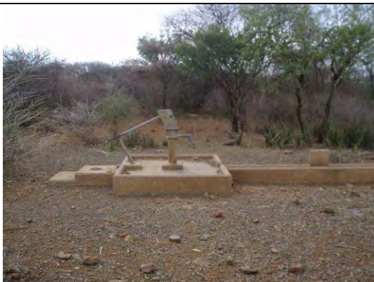
(写真-7) 東ポコット県、要請サイト 146 付近のハンドポンプ。10 年前に設置されたが現在故障中で修理予定。
