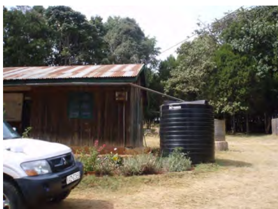
(写真-12) マリガット県、トタン屋根を利用して降雨を貯留するタンク。
