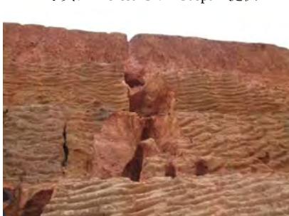
Pomerode 市の赤黄色土壌の切土の浸食状況 浸透水により容易に劣化し浸食を受け易い。
