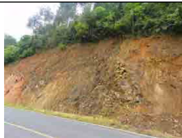
Talude rochoso com 60 graus, na parte central
