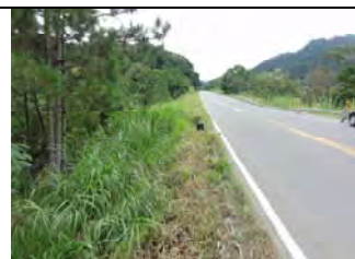
Erosão do talude do vale na parte de Gaspar.
