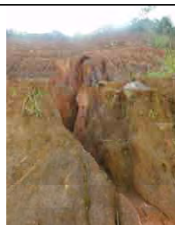
Erosão grande com solo de granulometria fina na parte central do talude
