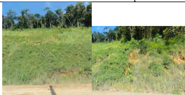
Existem cortes no talude da lateral de Luiz Alves
