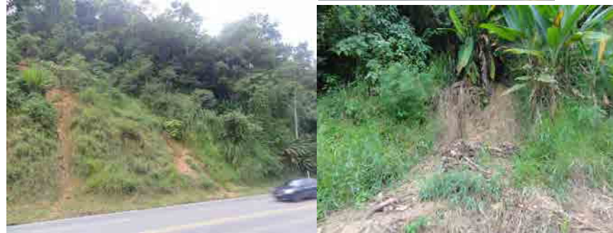
Talude com partes propensas ao rompimento, lateral da cidade de Massaranduba
