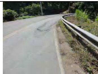
Danos no pavimento devido à infiltração da água
