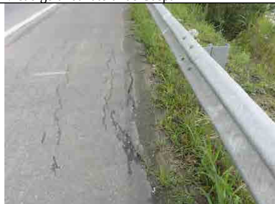
Rachaduras no pavimento das estradas
