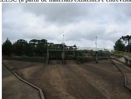
Comporta do vertedouro da barragem Pinhal
