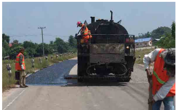
舗装損傷箇所の修復(2) 路面の損傷箇所を DBST により補修している
