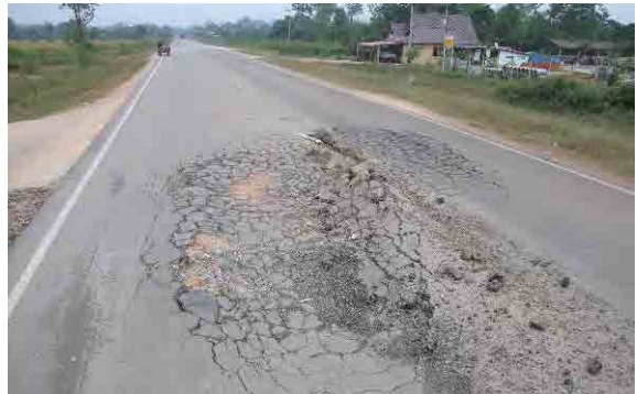
舗装の損傷箇所 車道中央部に亀甲状のクラックが発生している
