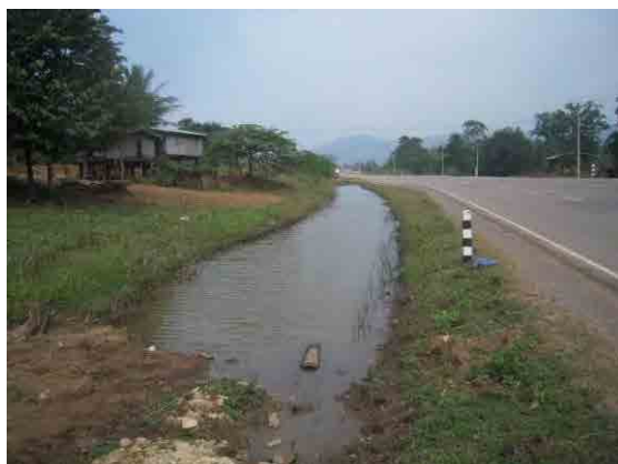
沿道排水不良 (ピン郡付近)
