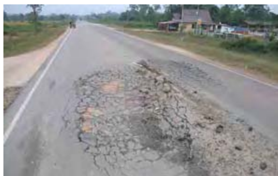
舗装の損傷箇所 車道中央部に亀甲状のクラックが発生している
