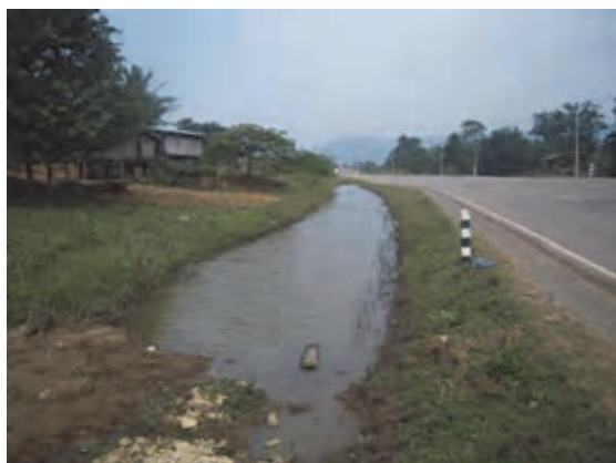
沿道排水不良 (ピン郡付近)
