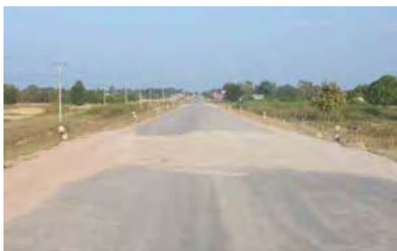
パランサイ盛土区間 路面の損傷度合いが著しい
