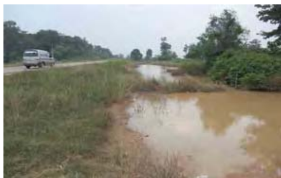
道路脇の排水不良 排水路がないため雨水が溜まっている
