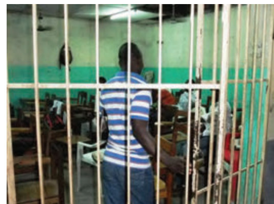
写真-4 自動車科講義室-1 騒音や振動を発生する実習室と隣接し、座学に必要な遮音性を確 保できていない。
