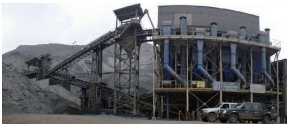
【Planta de Trituración Secundaria y Colector de Polvo】
