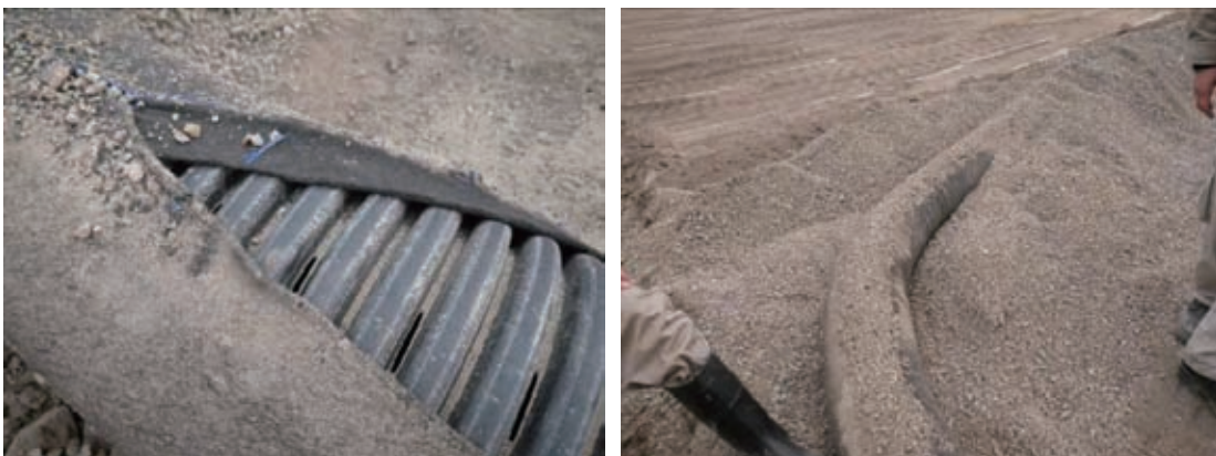
Foto 6.10 Instalación de Captación de Agua del Dique de Relaves No.4
