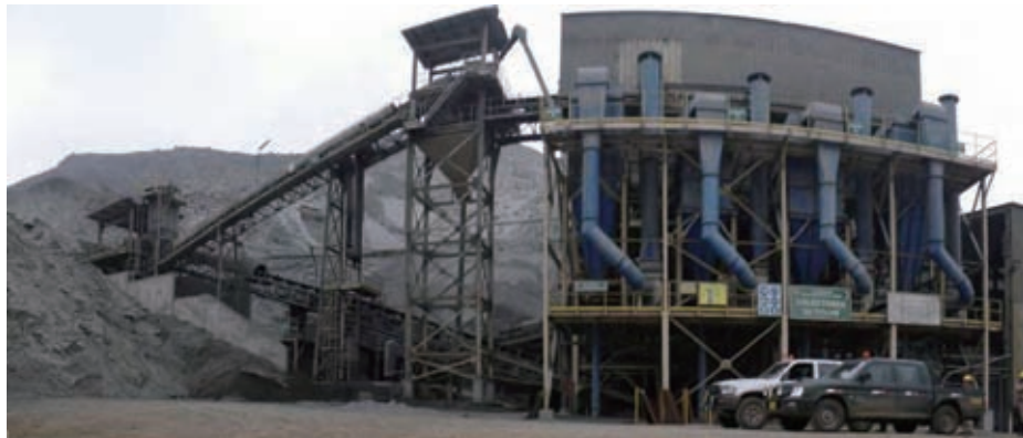
【二次破碎設備と集塵装置】
