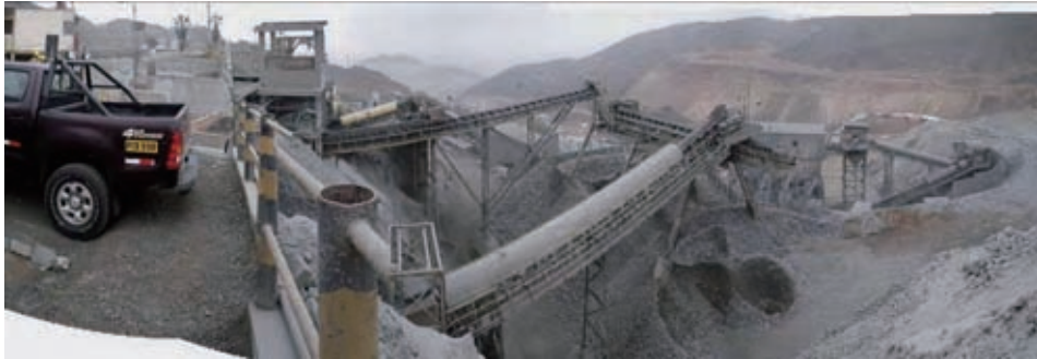
【受入・一次破碎設備】
