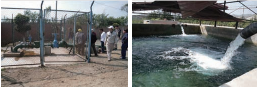
写真 6.6 取水井戸の状況
