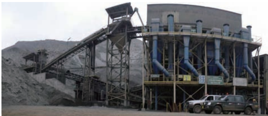
【二次破碎設備と集塵装置】
