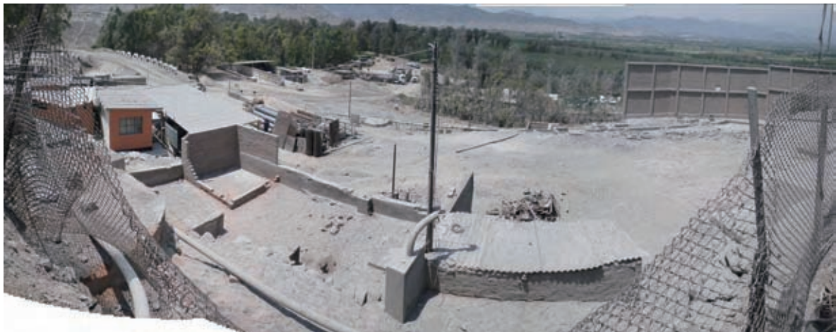
写真 6.15 段階的閉鎖中の水銀除去設備
