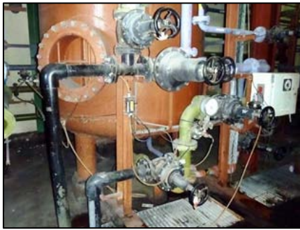
写真4-30 タンク周りのバルブと配管
