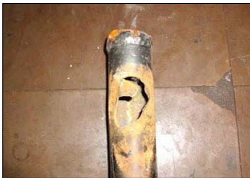
写真 4-2 スチームカットにより破孔した過熱器管
