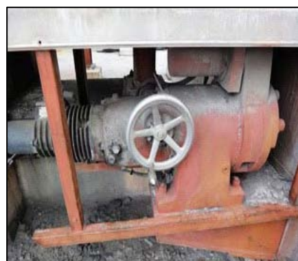
写真 4-11 押込通風機ベーン駆動装置
