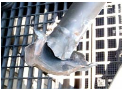
写真 3-1 スートブロウ蒸気によって破断した蒸気管
