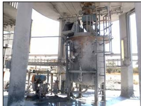
写真 4-33 灰輸送ポンプ
