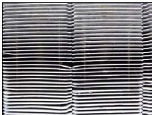
写真 4-16 復水器の冷却フィン
