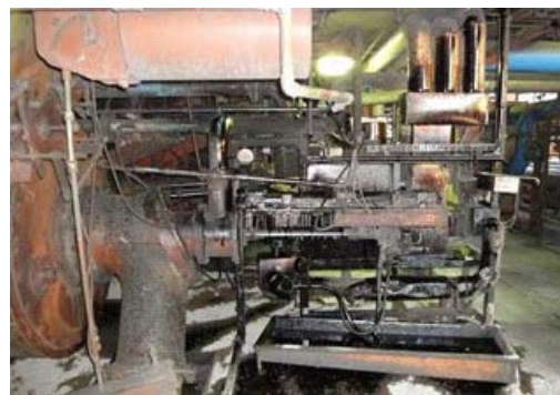
写真 4-5 バーナーから漏れた重油
