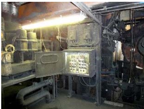
写真 4-4 ボイラ前の汚れが付着したスイッチボックス
