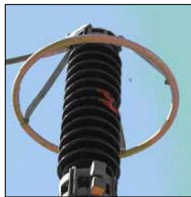
写真 4-21 避雷器の碍子の 破損
