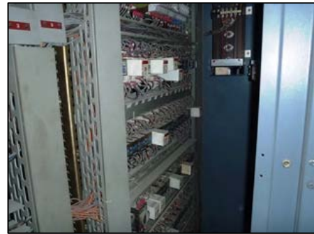
写真 4-35 非常用発電機制御盤
