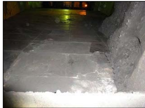
写真 4-7 バンカー内のライニングのはがれ
