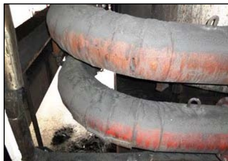
写真 4-10 ベント部からの微粉漏洩
