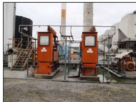
写真 4-36 エンジン駆動消火ポンプ
