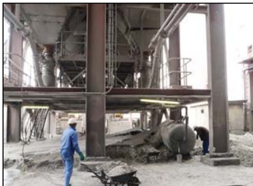
写真 4-32 ESP下部の灰の堆積状況
