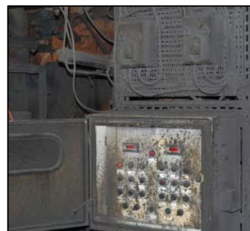
写真 4-27 灰で覆われたケーブルラック
