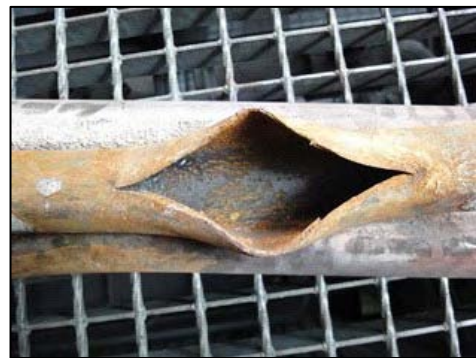
写真 4-3 温度超過により破孔した過熱器管
