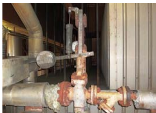
写真 3-2 スートブロウ蒸気調節弁(分解点検されていない)
