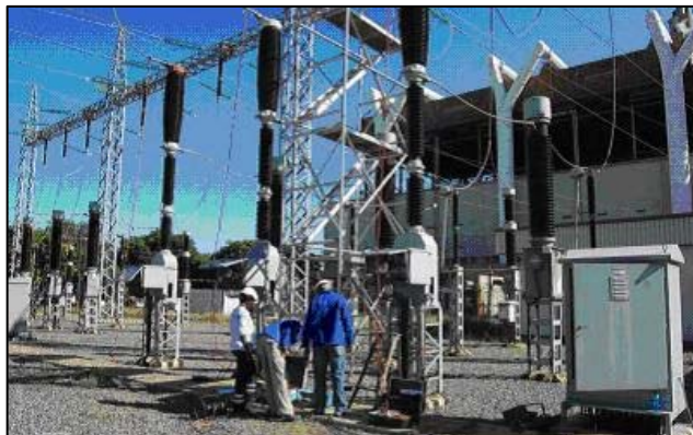
写真 4-20 遮断器の抵抗測定・動作時間測定
