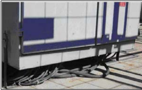
写真 4-22 変圧器下部に直接敷設されたケーブル
