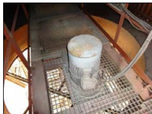
写真4-17 冷却タワー内のモータ
