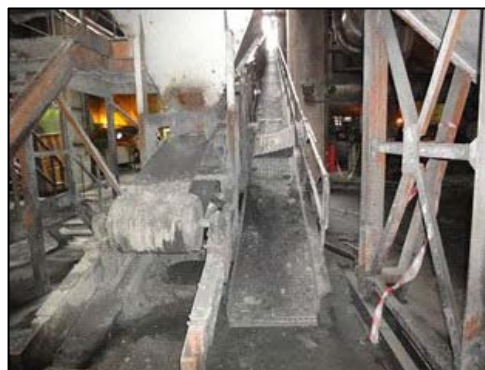
写真 4-13 炉底灰処理装置
