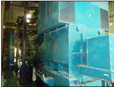
写真 4-34 エンジン駆動非常用発電機
