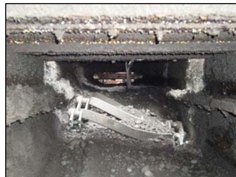
写真 4-9 給炭機内部(閉塞の状況)
