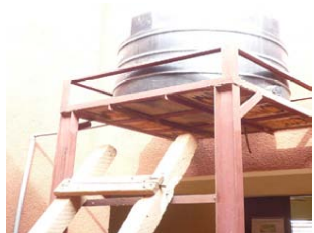
既存 CSPA 内に設置された水タンク
