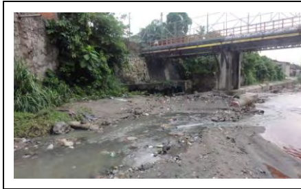
San Salvador 市と Soyapango 市の境界付近。 Acelhuate 川の橋梁。左岸側護岸が洗掘を受けている。 年に 1 回程度 橋梁床版下-50cm 程度まで河川水位が達する。 橋脚も洗掘を受けている。
