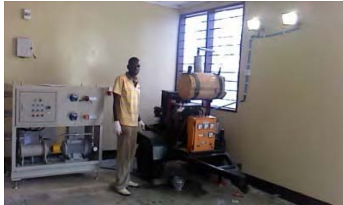
エマルジョン製造→発電機稼働→電気使用試験（投光器）
