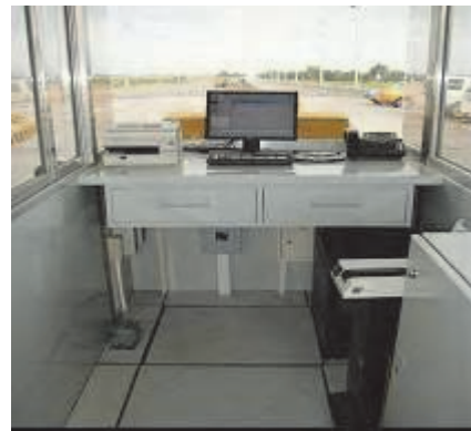
写真 6-8 トールブース内料金收受装置
