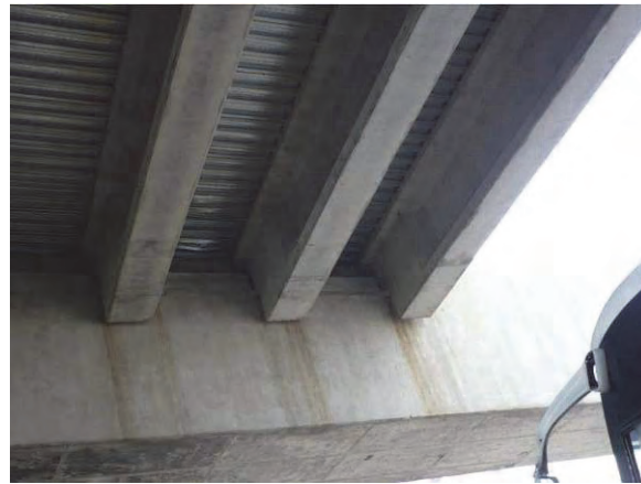
写真 5-2 支点部で桁を切り欠いた PC-I 桁と床版下面の波形鋼板
