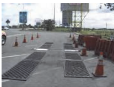
写真6-7 車重計測設備
