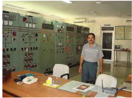
ニムラナ 220kV 変電所 2
