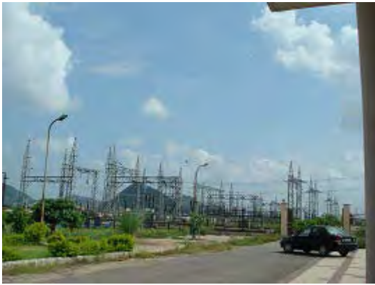
ニムラナ 220kV 変電所 1
