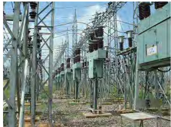
33kV 配電線引き込み口
