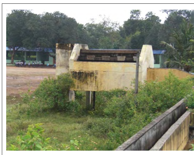
エアレータ全景
