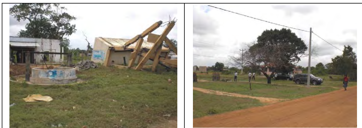
バランシングタンク(破壊され、使用不可)
