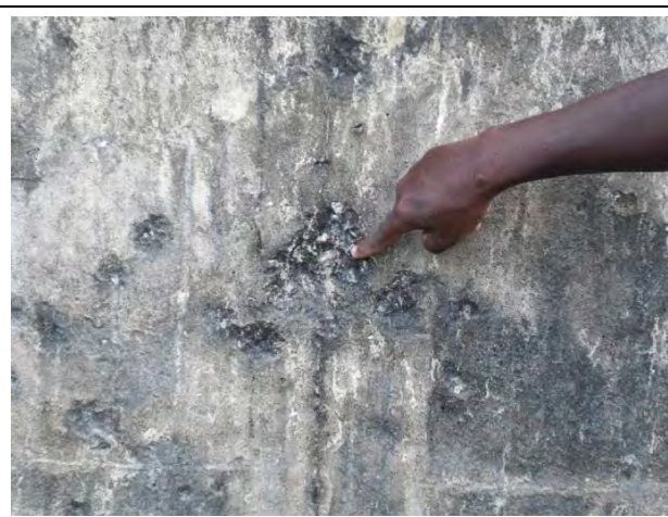
緩速ろ過池内面側壁の被弾箇所
