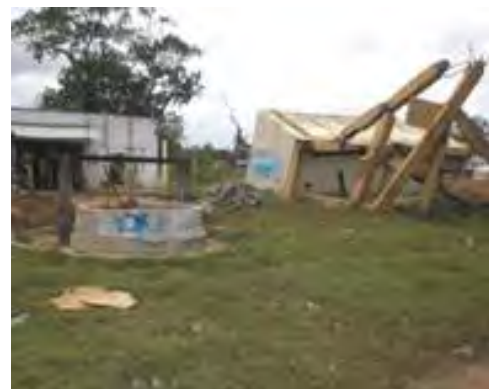
写真-8 : Balancing Tank 倒壊状況
