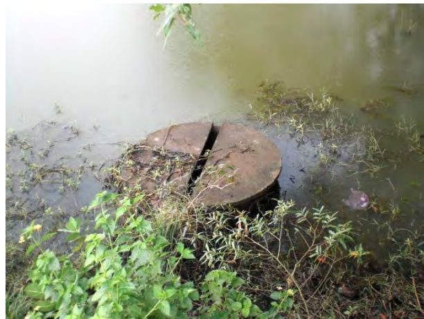
取水ピット(Dry Aru 貯水池内に設置)
