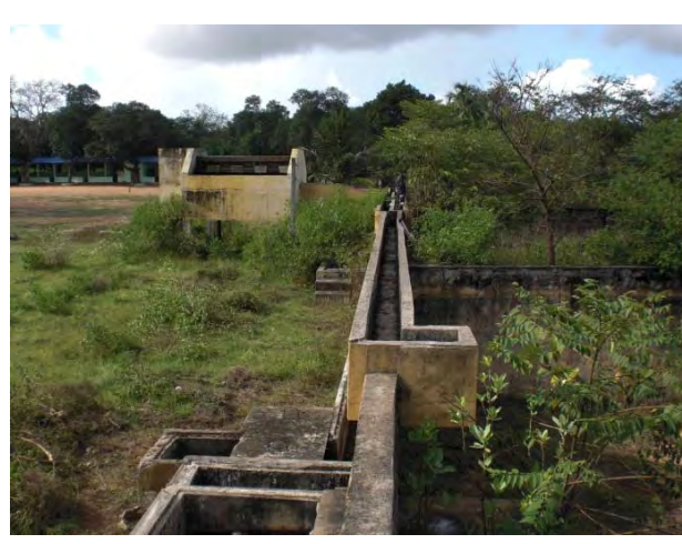
緩速ろ過池流入水路及び流出ピット
