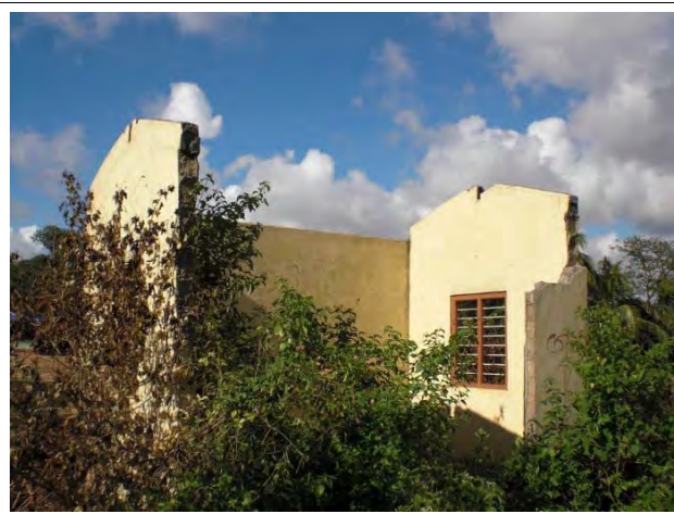
自家発電機棟
