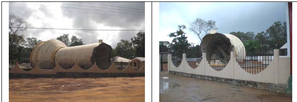
高架水槽(倒壊後)
