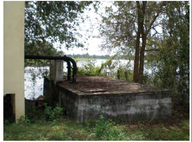
取水タンク全景
