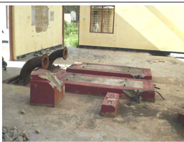
薬品/ポンプ棟・浄水池 送水ポンプ撤去跡
