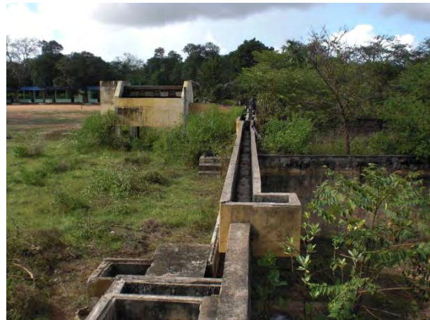
緩速ろ過池流入水路及び流出ピット
