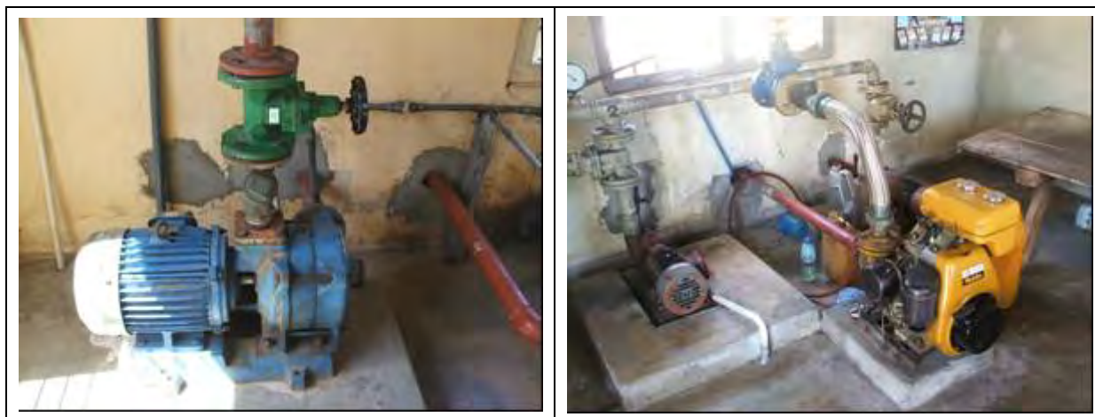
パブニア ポンプ設備
