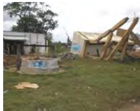
写真-8 : Balancing Tank 倒壊状況
