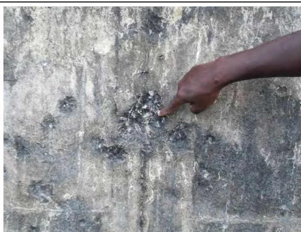
緩速ろ過池内面側壁の被弾箇所
