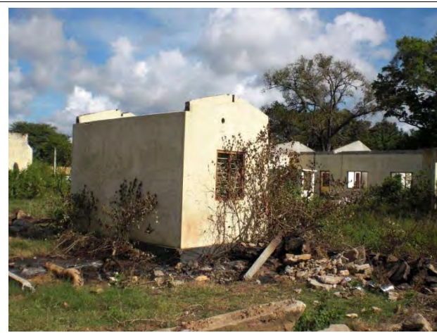
自家発電機棟
