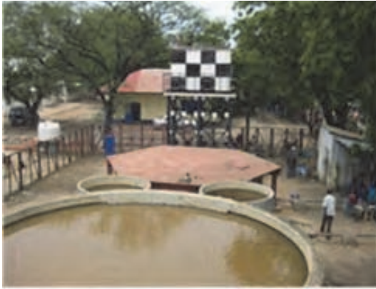
写真 5-18 アッパーナイル大学浄水施設
