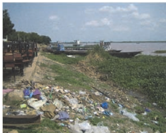
写真 5-32 係留棧橋より南側（下流側）の護岸
