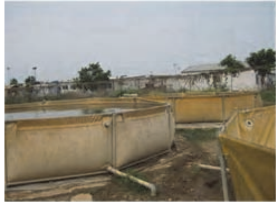
写真 5-19 UNMIS 浄水施設
