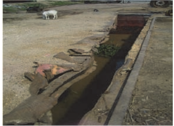
写真5-34 係留棧橋前面。鉄製であり、前面はフェンダーもなく変形している。
