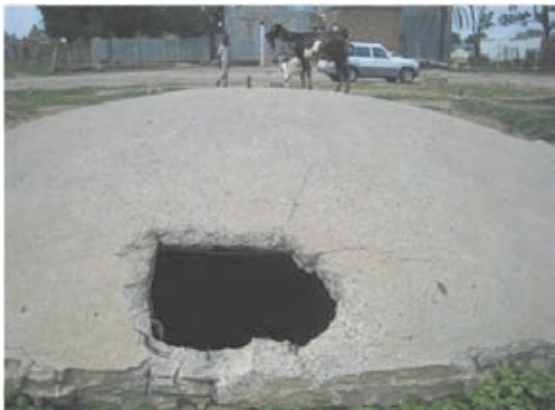
写真 6-5 地下の貯油施設
