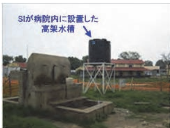
写真 5-14 SI による高架水槽
