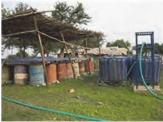
写真 5 - 9 RWS による簡易浄水施設
