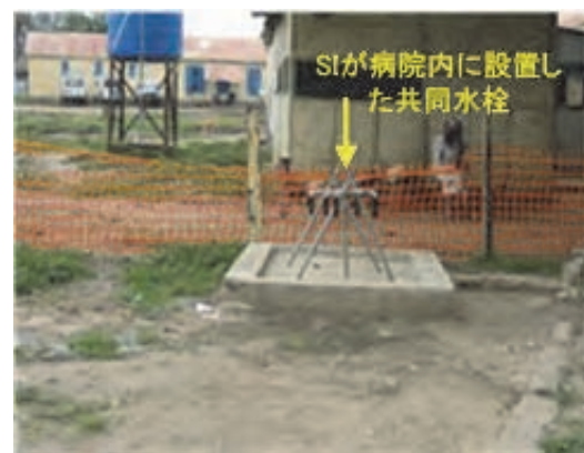
写真 5-15 SI による共同水栓 (病院)
