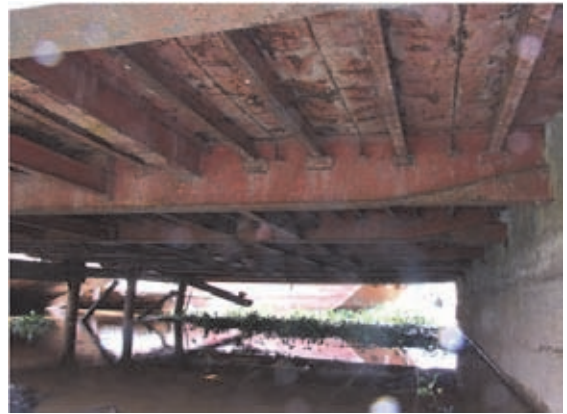
写真5-36 前面以外は杭がなくビームで支える構造。床板は錆が進行
