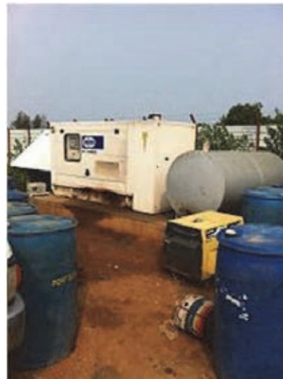
写真 3-8 ADRA コンパウンドの発電機および石油備蓄
