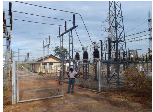
132/33 kV Habarana GS
