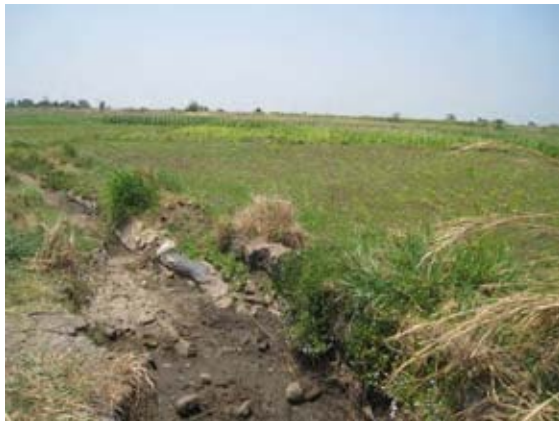
土砂が流入し崩壊した水路 (マチンガ県Chibwana地区)
