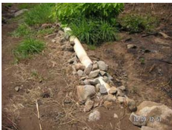
不適切な設計で日射にさらされている 導水用パイプ (マチンガ県Chanyungu地区)
