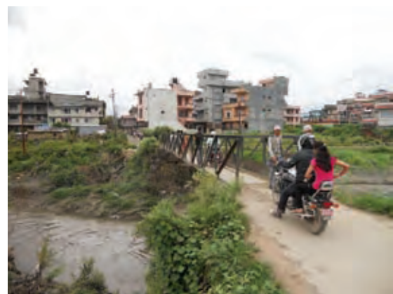
未整備な橋梁：カトマンズ市内のドビ川に架かる仮設トラス橋。バイクと歩行者が利用している。
