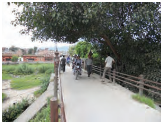
未整備な橋梁：バグマティ川に架かる日本の ODA で整備されたサンカモル橋。バイクと歩行者が利用している。
