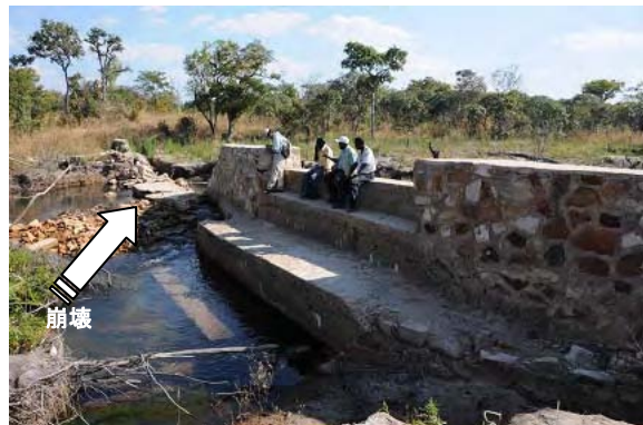
Kapaka 取水堰：2008 年、洪水により堰右岸側が倒壊、流出した。
