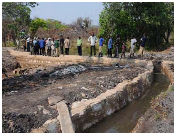
2010年9月にアップグレードされたChibolya 恒久堰サイトである（ルアプラ州 Kawambwa 郡）。写真右側が水路である。恒久堰によって安定した取水がなされている。堰延長 24 m、堰高 2 m である。
