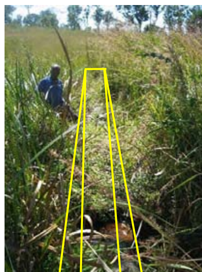
建設後 10 年余りのうちに漏水により利用が放棄された取水堰。
