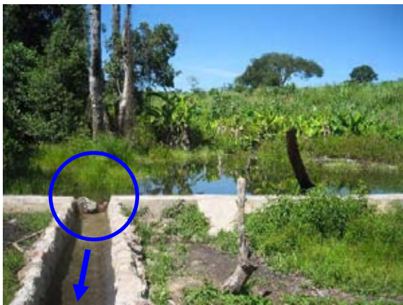
用水路起点に水量制御施設を付帯していないため、石や草を積んで用水路への流入量をコントロールしている。
