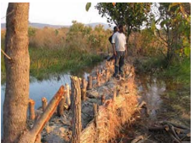
ダブルラインと呼ばれる簡易堰である。シングルラインを2列建設し、その間に粘土を詰め締め固めている。堰を通過する漏水を大きく低減できるとともに、50cmを超える水位の堰上げも容易となる。
