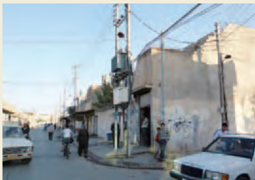
円借款で供与した配電用資機材(北部クルド地域のエルビル)
