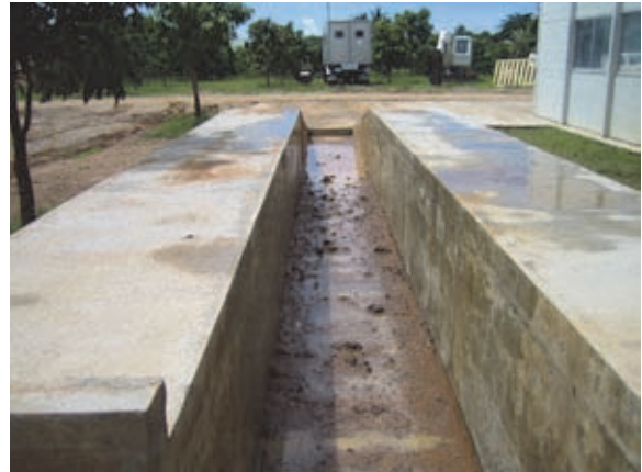
中央整備工場に設置された 点検・洗車ステーション
