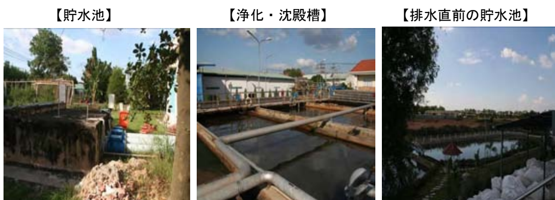
図 2-16 既存工業団地（LOTECO）における廃水処理施設の例
